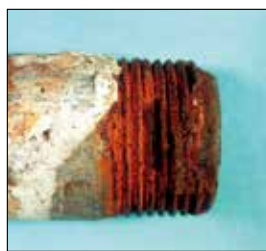
ねじが欠落したライニング鋼管
